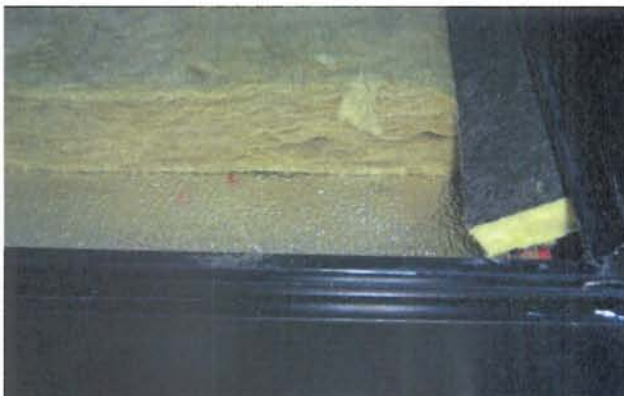
Ansicht der Isolierung view of the insulation
